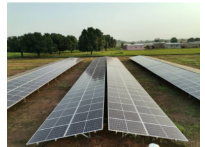
Mali: Ländliche Elektrifizierung
